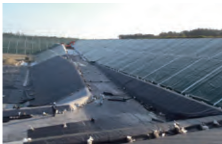
処分場で使用されている遮水シート
